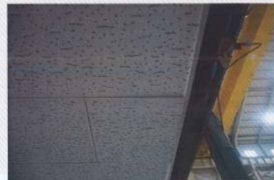
Photo B.16 시험 후 천장재 측면부
