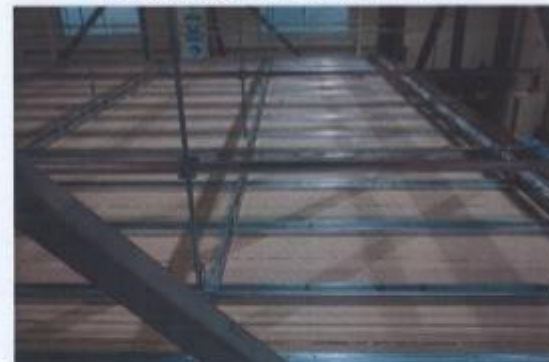
Photo B.14 시험 후 천장재 상부
