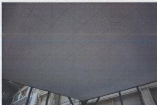
Photo B.15 시험 후 천장재 하부
