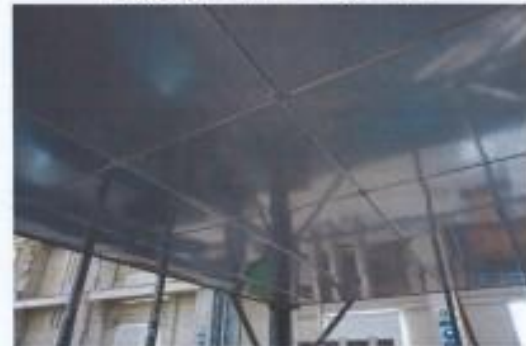
Photo B.14 시험 후 천장재 하부
