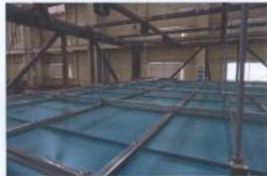
Photo B.12 시험 후 천장재 상부
