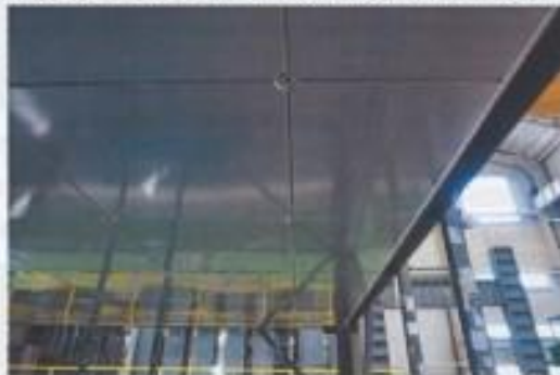
Photo B.15 시험 후 천장재 측면부 & Molding
